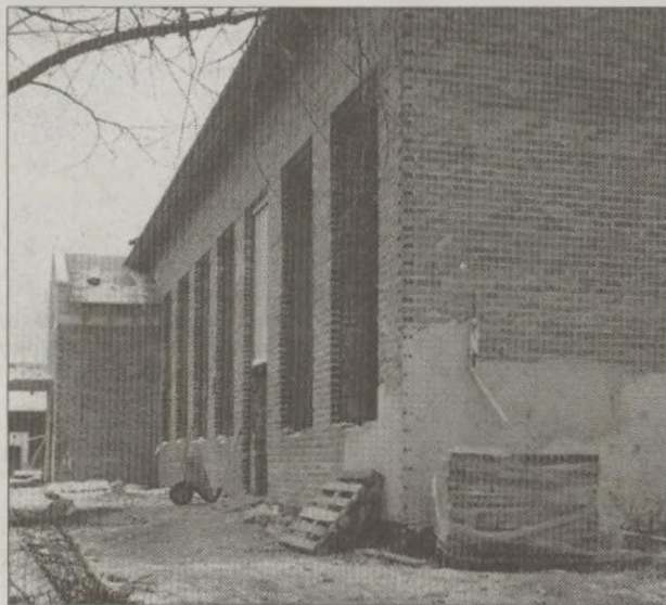
ZDJĘCIA ANDRZEJ BURYŁO Sala gimnastyczna w Czeszowie powstaje w bezpośrednim sąsiedztwie szkoły podstawowej. Poprzez łącznik będzie tworzyła z nią całość. Inwestycja zostanie ukończona w lipcu br., tuż przed wejściem w życie reformy oświaty.
